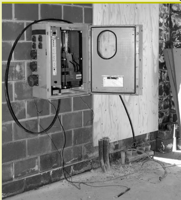
werfkast elektriciteit (foto Vreg)
