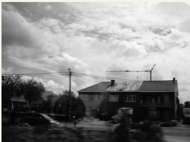
Stormschade aan het dak ...
