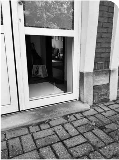
schade door inbraak
